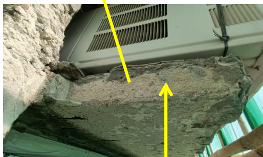
台邊未有鋼筋支撐
